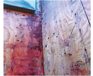
外壁内部の雨漏りの跡 (修補工事のため外壁をはがした状態)
