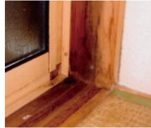
室内への雨漏り
